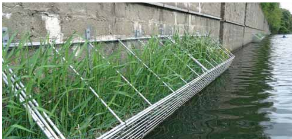
Fascines végétalisées le long de l'ancien quai de chargement du charbonnage de la darse de Cheratte.
